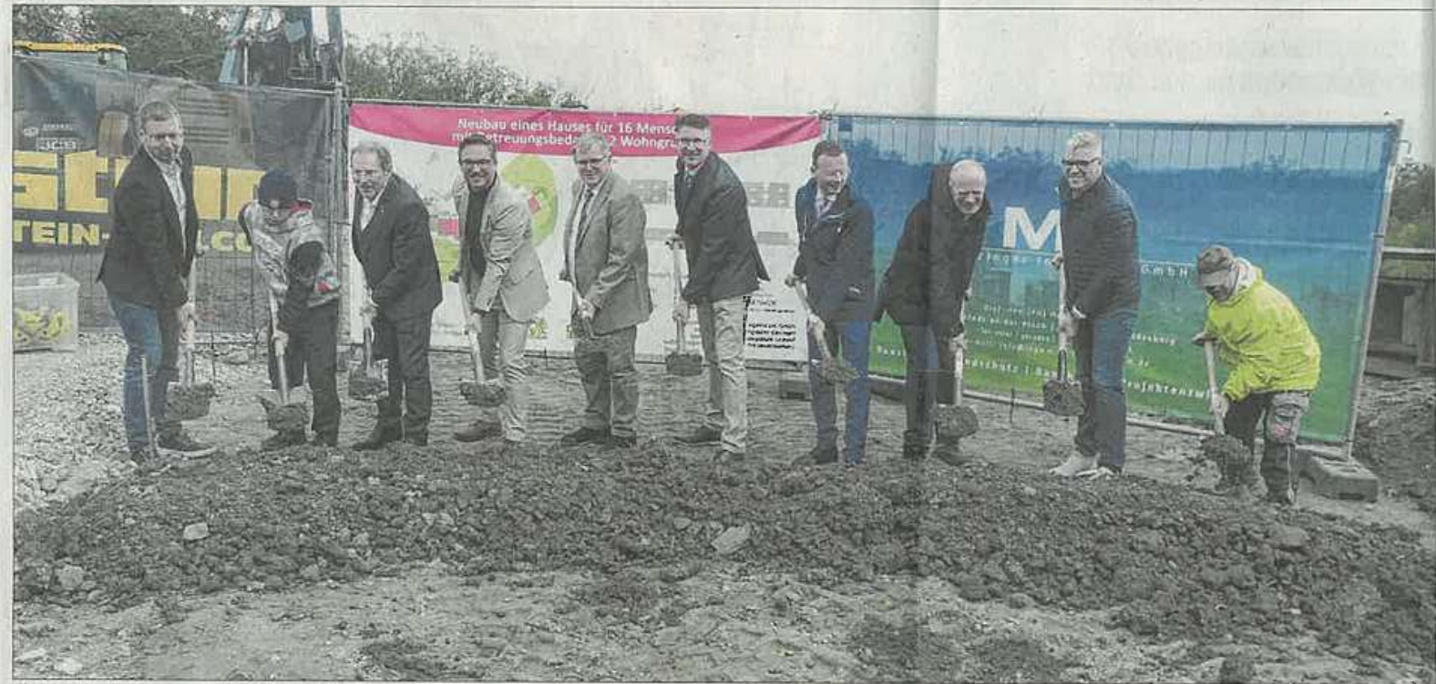
Neben Vertretern aus Politik und Wirtschaft griffen auf dem Hausenhof Bewohner und Mitarbeiter zum Spaten, als in der Camphill-Dorfgemeinschaft der offizielle Beginn des Neubaus zelebriert wurde. Foto: Helmut Meixner
